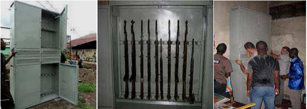
Image de l'Installation de deux dépôts mobiles d'armes préfabriquées à la Prison de Makala (Kinshasa-RDC) dans le cadre de la mise en œuvre du projet financé par le gouvernement Allemand (Phase I)
